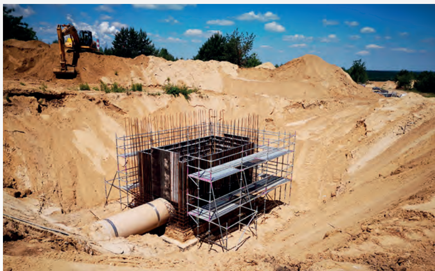
Fot. 1. Odprowadzenie wody nadosadowej z nowej studni na składowisku „Zwałowisko” (zdjęcie: własność firmy ELMEN)
