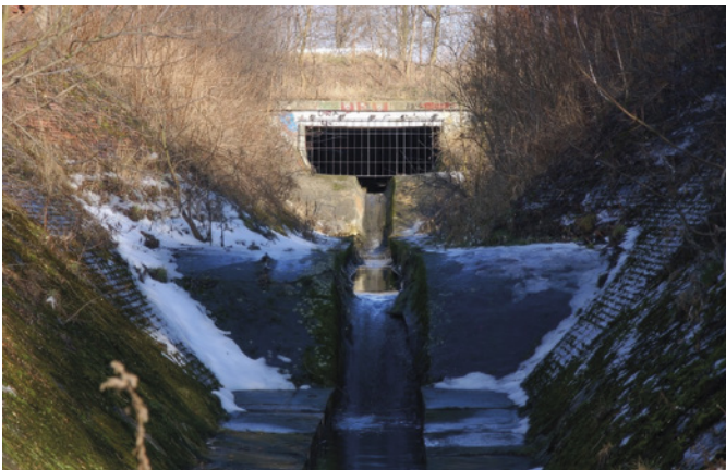
Rys. 5. Wylot krytego kanału rzeki Karolewki do otwartego odcinka rzeki Karolewki zabezpieczony stalową kratą
