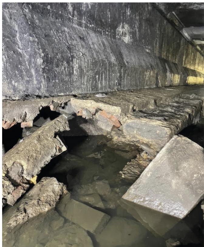
Rys. 10. Uszkodzone fragmenty chodnika kanału
