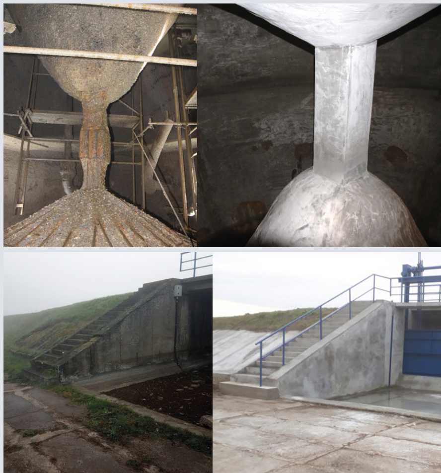
Przykładowe zdjęcia z realizacji obiektów przed naprawą i po naprawie
