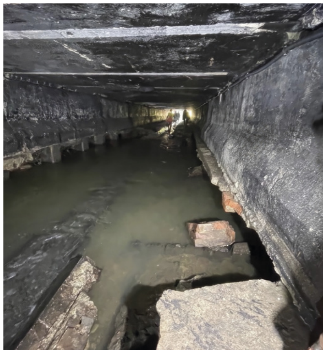
Rys. 9. Całkowicie zniszczone dno kanału na odcinku poniżej kaskady
