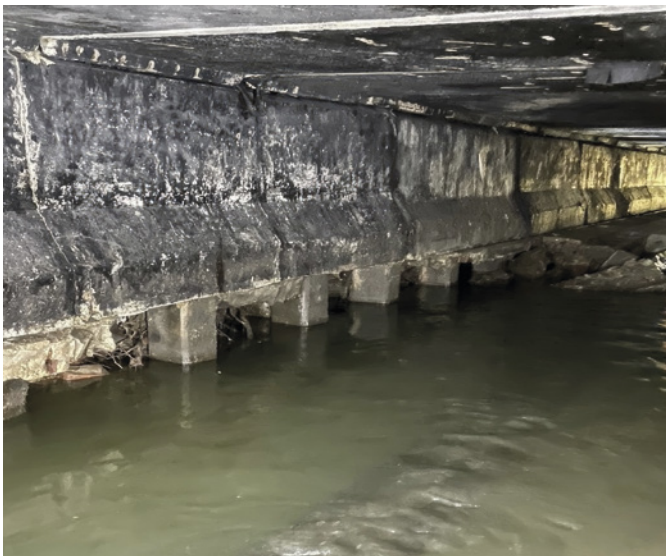
Rys. 8. Odsłonięte na skutek awarii chodników i kinety pale fundamentowe ścian bocznych kanału
