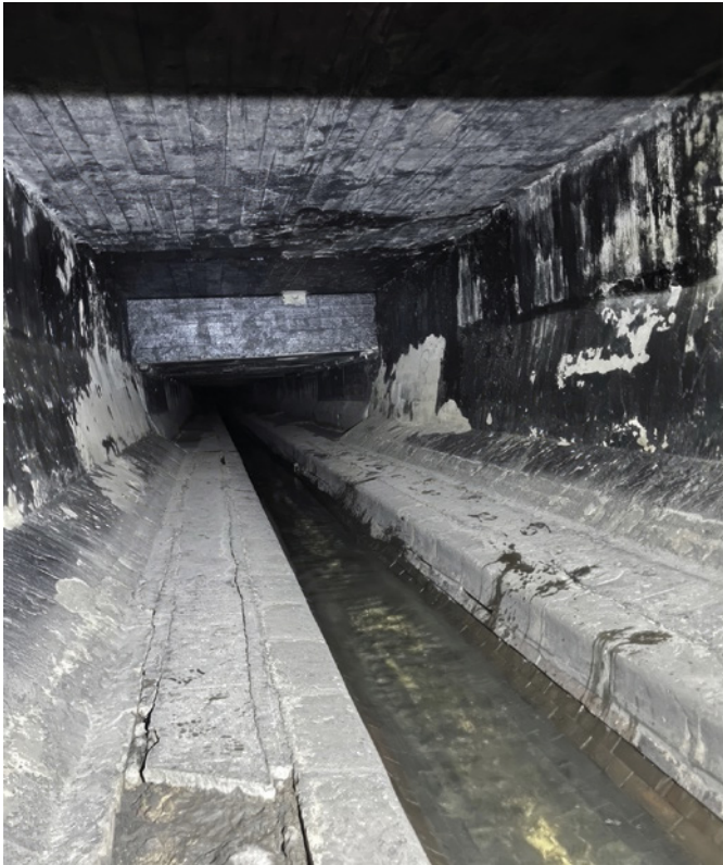
Rys. 7. Stan powierzchni płyty stropowej i ścian obudowy kanału rzeki Karolewki
