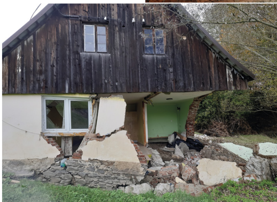
Zniszczony budynek na terenie wsi Trzebieszowice, fot. J. Miszczak
