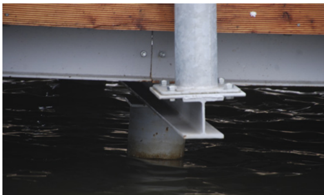
Fot. 3. Brak pionowości latarni, skrzywienie belki oczepowej, odchylenie od pionu pała fundamentowego w odległości 25 m od przyczółka, powierzchniowa korozja pała na poziomie lustra wody (widok od strony pomostu) Fot. Dariusz Zaręba
