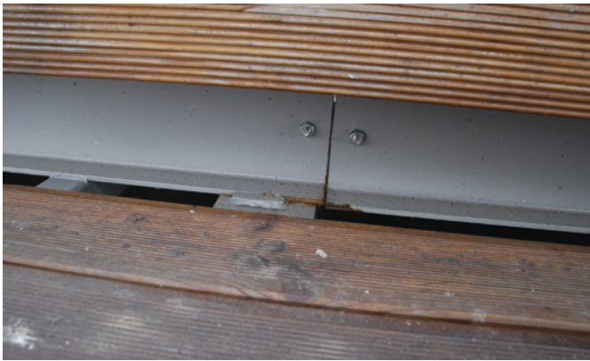
Fot. 1. Przesunięcie końca trzeciej belki i początku czwartej, brak oparcia czwartej belki, korozja powierzchniowa belek Fot. Dariusz Zaręba
