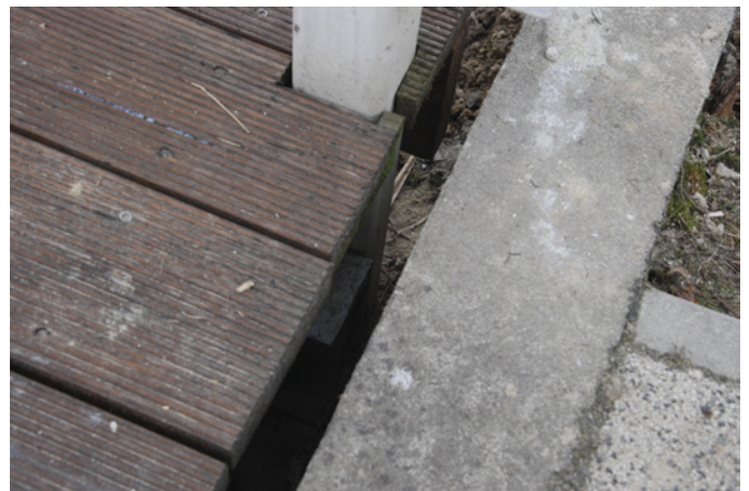
Fot. 6. Przerwa między pomostem a górną powierzchnią przyczółka z prawej strony (5 cm) Fot. Dariusz Zaręba
