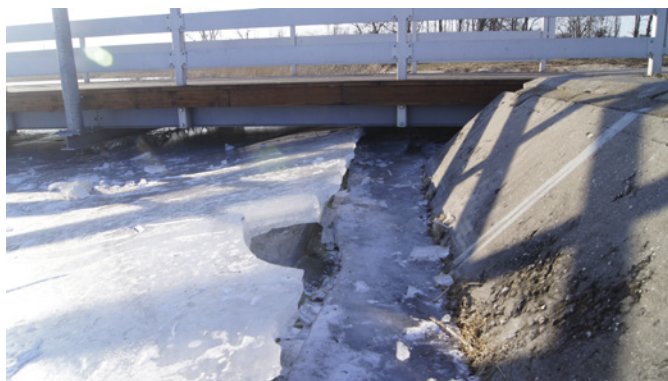
Fot. 7. Widok pokazujący kierunek naporu kry lodowej ostatniej zimy, skutkujący pęknięciem fragmentu tafli lodowej. Źródło zdjęcia: materiał inwestora
