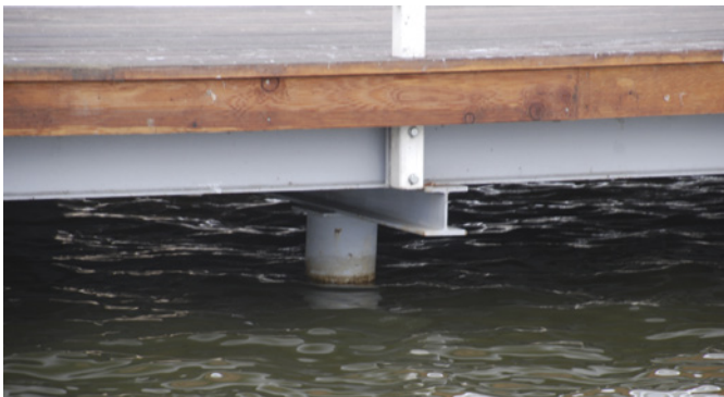
Fot. 2. Odchylenie od pionu pała fundamentowego w odległości 20 m od przyczółka, powierzchniowa korozja pała na poziomie lustra wody Fot. Dariusz Zaręba
